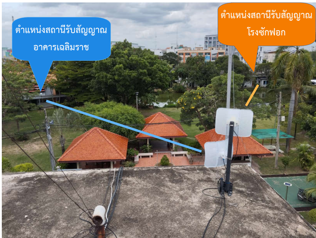
7. ภาพการติดตั้ง Wi-Fi Outdoor แบบ P2P ในสถานที่จริง
